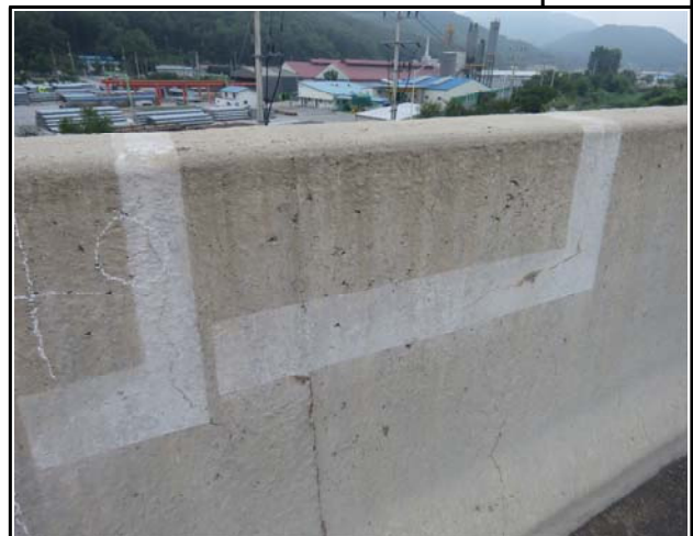
내 용 S2 방호벽 균열 cw=0.2/1.5
