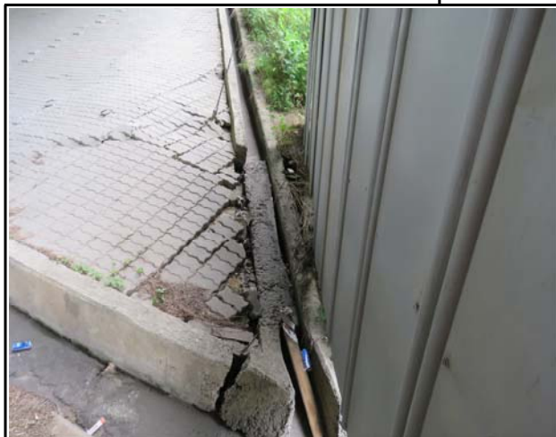
내 용 A1 우측배수로 파손 L=2.5
