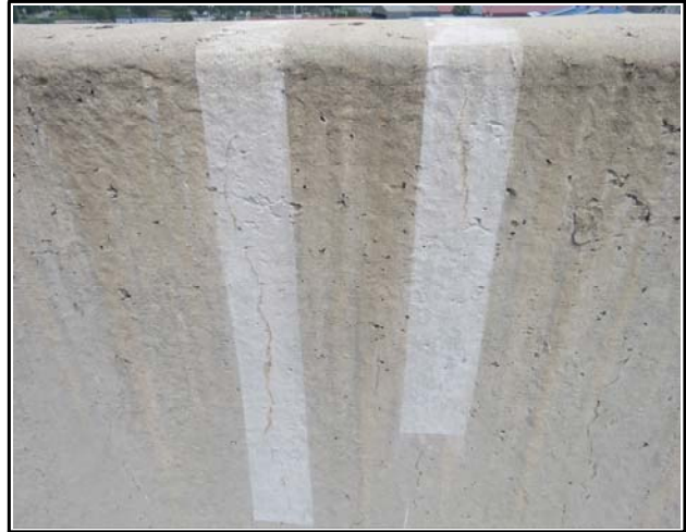
내 용 S3 방호벽 균열 cw=0.2/1.1
