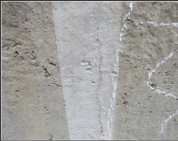
내 용 S2 방호벽 보수 미흡
