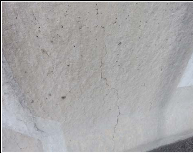
내 용 S1 방호벽 전구간 불규칙 균열
