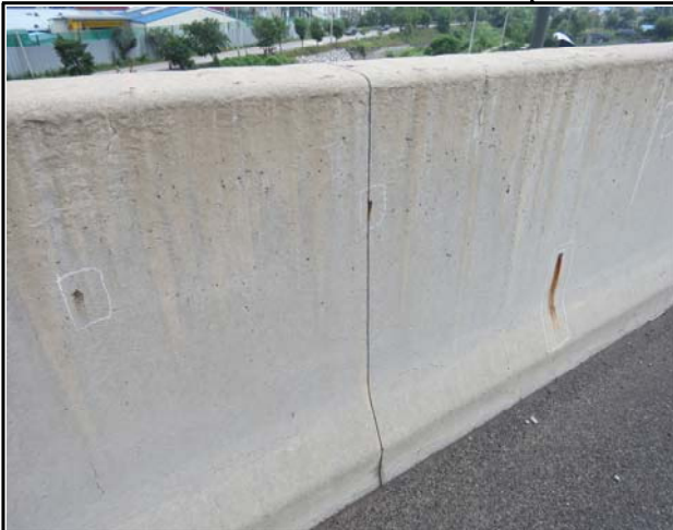
내 용 S3 방호벽 녹물유출
