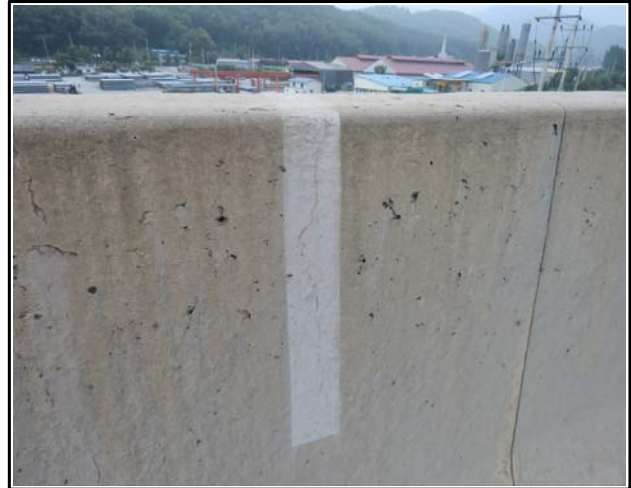
내 용 S1 방호벽 균열보수 미흡
